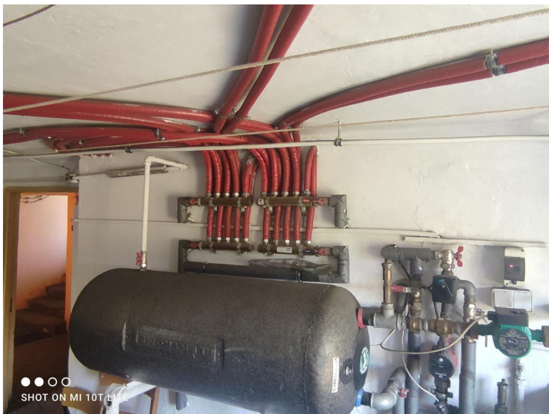
Widok instalacji c.o. w systemie rozdzielaczowym, podgrzewacza c.wu. pozostałej armatury w pomieszczeniu sąsiednim-obok kotłowni
