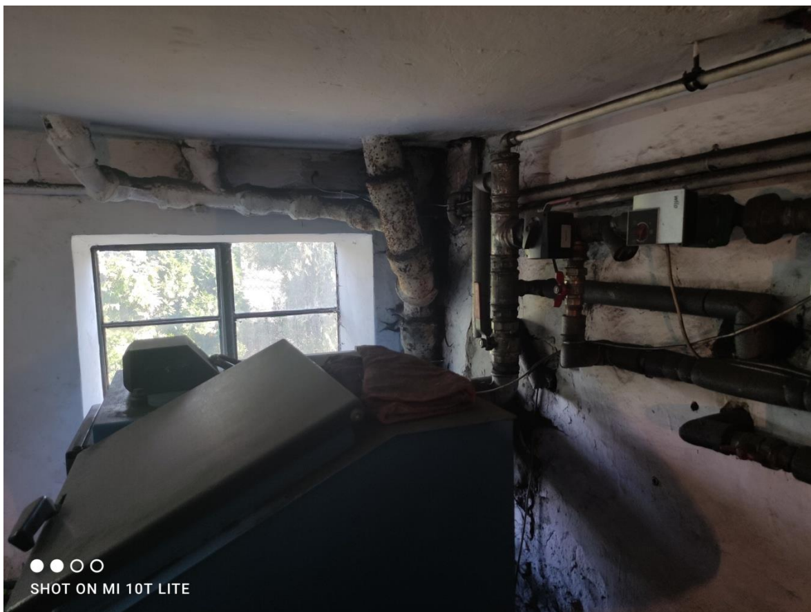
Widok kotłowni z kotłem węglowym
